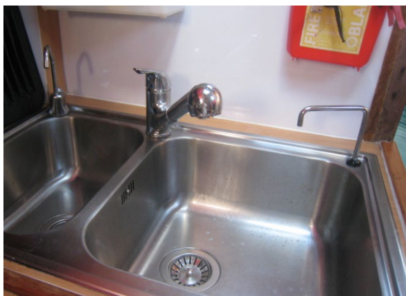
Les trois robinets à l'évier : eau potable, eau douce et eau de mer (de g. à d.)
