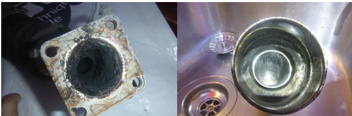
Avant et après le nettoyage du coude d'échangeur. Vu de l'extérieur il n'avait pas l'air sale, mais on voit pourtant à gauche qu'il commençait malgré tout à se colmater de calamine
